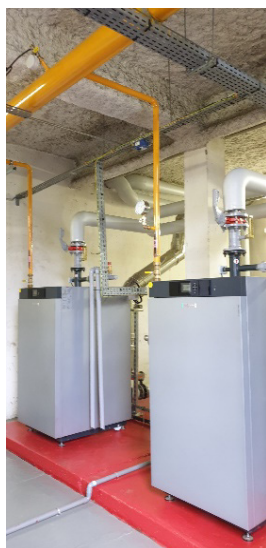
Nouvelle chaufferie de la résidence Saint-Bernard
